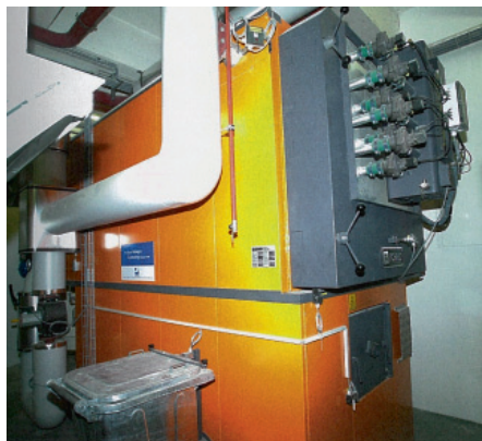
Projektbeispiel 1: Holzpelletkessel für Nahwärmeverbund.
